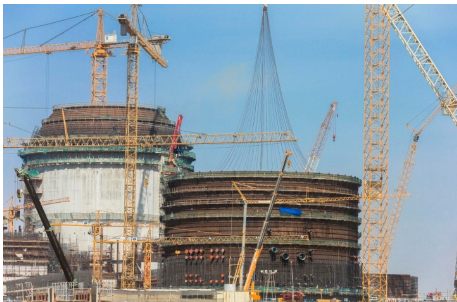
FIG. 1. Construction des tranches 1 et 2 de la centrale nucléaire de Barakah, aux Émirats arabes unis, en août 2014. La construction de la troisième tranche a commencé en septembre. (Crédit photo : ENEC)
