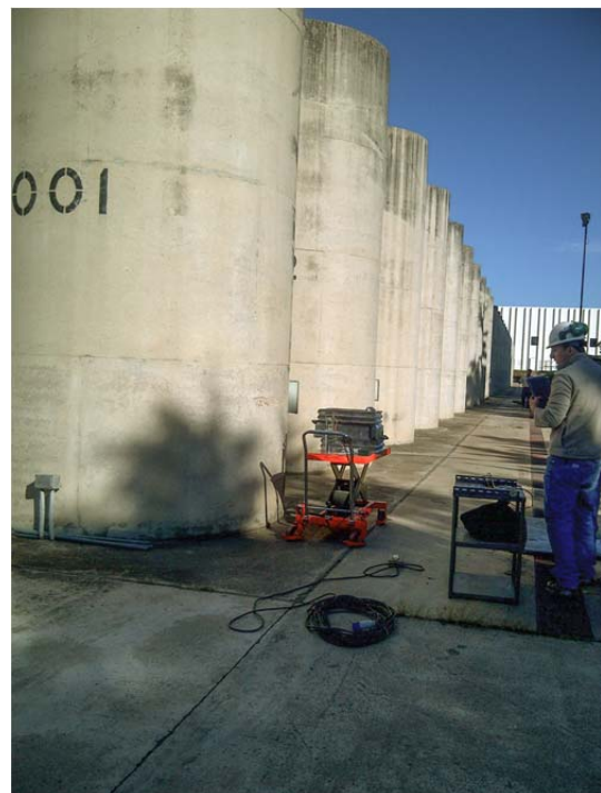
图2. 专家们在阿根廷恩巴尔斯核电厂干法贮存设施检查乏燃料密封完整性和钢筋混凝土贮存仓的结构完整性，这是通过原子能机构协调研究项目支持的乏核燃料及相关贮存系统部件超长期贮存性能研究的一个例子（照片由国家原子能委员会/阿根廷核电公司提供）。
