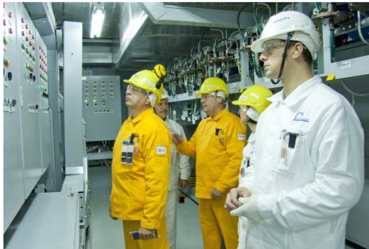
FIG. 4. Des examinateurs OSART accompagnés de personnel de la centrale examinent un tableau de contrôle –commande à la centrale nucléaire de Smolensk (Fédération de Russie).
