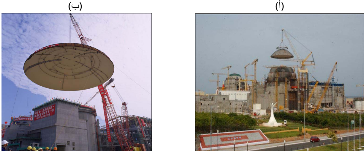
الشكل ٢ - رفع قبة الاحتواء لتركيبها في مكانها في (أ) محطة القوى النووية في كودانكولام في الهند (الصورة مقدمة من مؤسسة القوى النووية في الهند)؛ (ب) محطة لينجاو-٤ في الصين.
