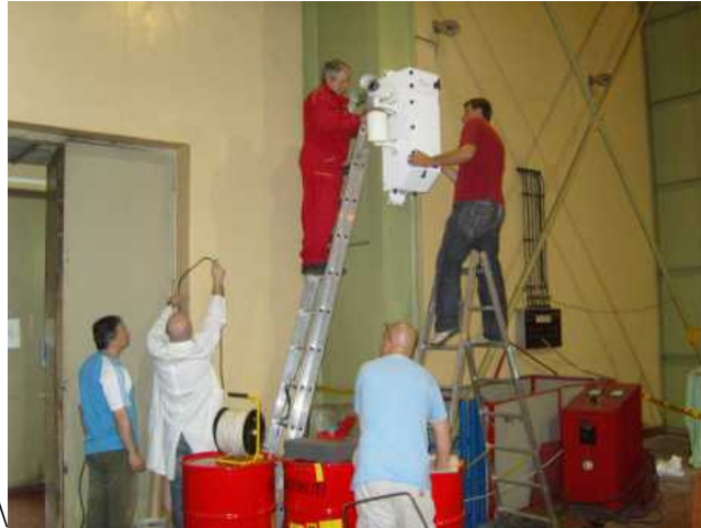
الشكل ٢ - تركيب معدّات الرصد عن بعد من أجل تحسين الحماية المادية لمرفق نووي.
