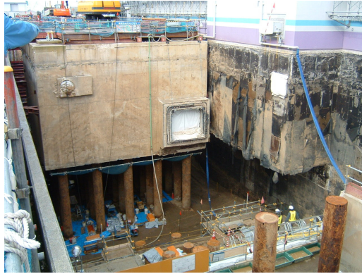
الشكل ٢ - إزالة وتنظيف واستبدال التربة الملوثة بالنفط تحت أعمدة أساس هيكل لا علاقة له بالأمان في محطة كاشيوازاكي كاريوا للقوى النووية.
