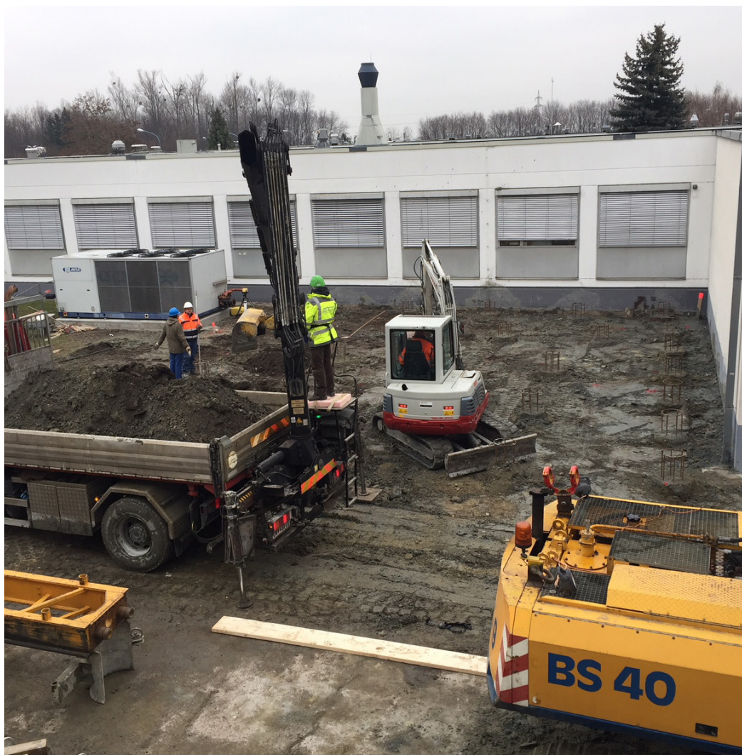
Construction d'une casemate destinée à abriter un accélérateur linéaire sur le site de l'AIEA à Seibersdorf (Autriche).
