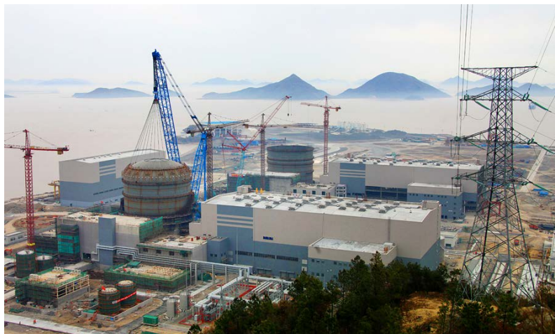
FIG. 3. Installation du dôme de confinement d'une tranche de la centrale nucléaire de Sanmen, une des nombreuses centrales nucléaires en construction en Chine, pays dont le programme électronucléaire est en expansion. (Crédit photo : CNNC)
