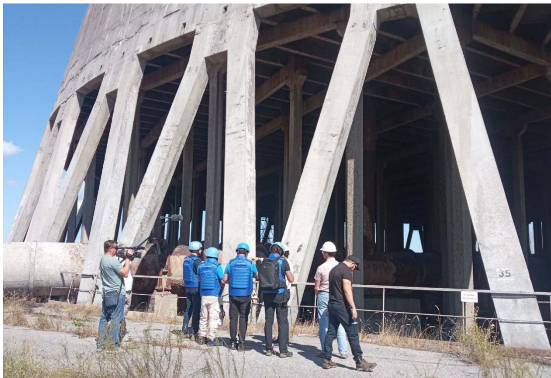
ИСАМЗ осматривает повреждения градирни 12 августа 2024 года (фото: ЗАЭС).
