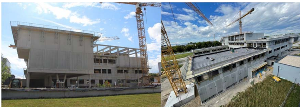
РИС. В.1. Работы по утеплению фасада и кровли МЛИП-2, сентябрь 2023 года. (Источник: МАГАТЭ)
