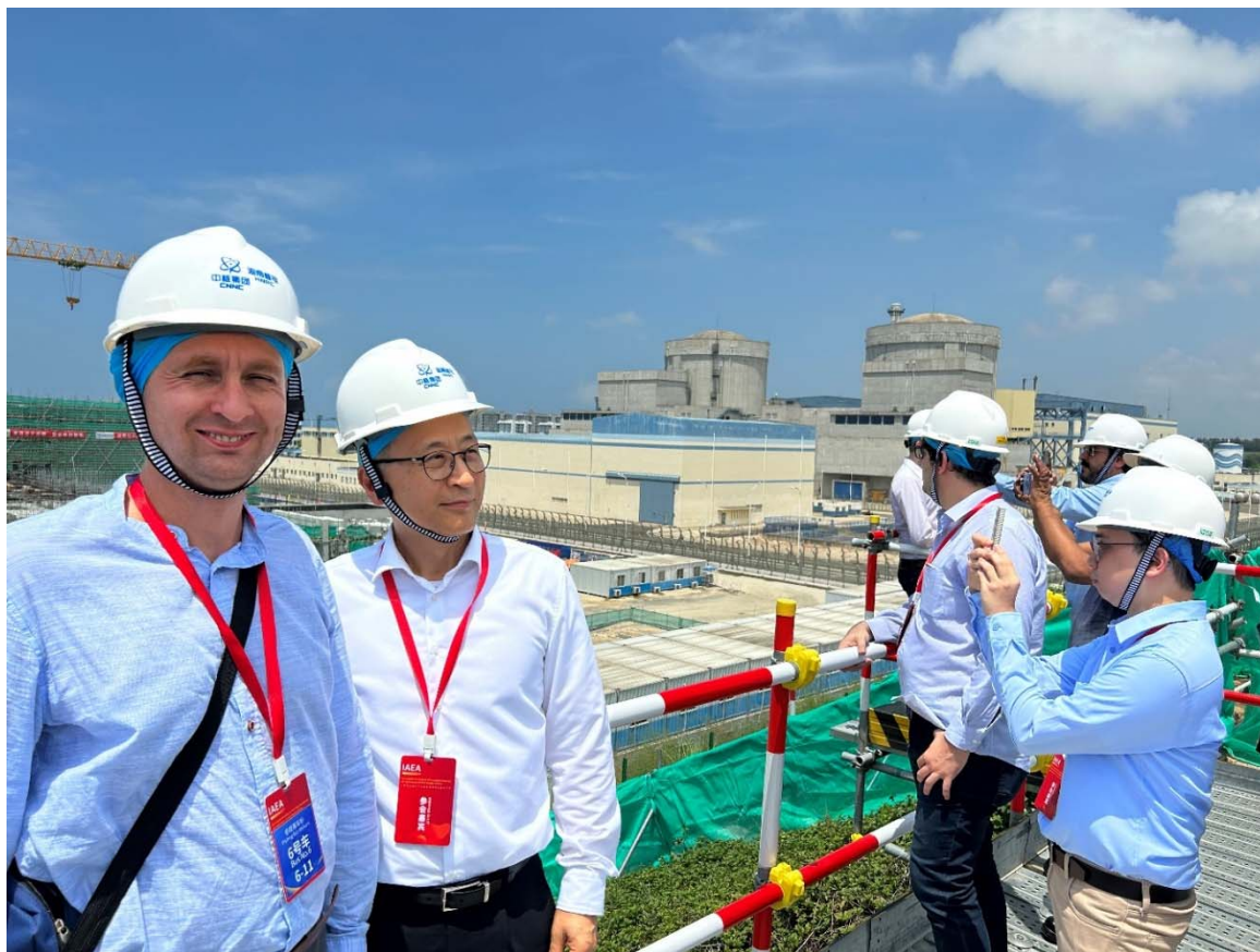
РИС. В.2. Посещение стройплощадки АЭС в рамках объединенных межрегиональных семинаров-практикумов по развитию технологий и применению ММР и по типовым пользовательским требованиям и критериям для ММР, состоявшихся в Китае в сентябре 2023 года. (Источник: МАГАТЭ)
