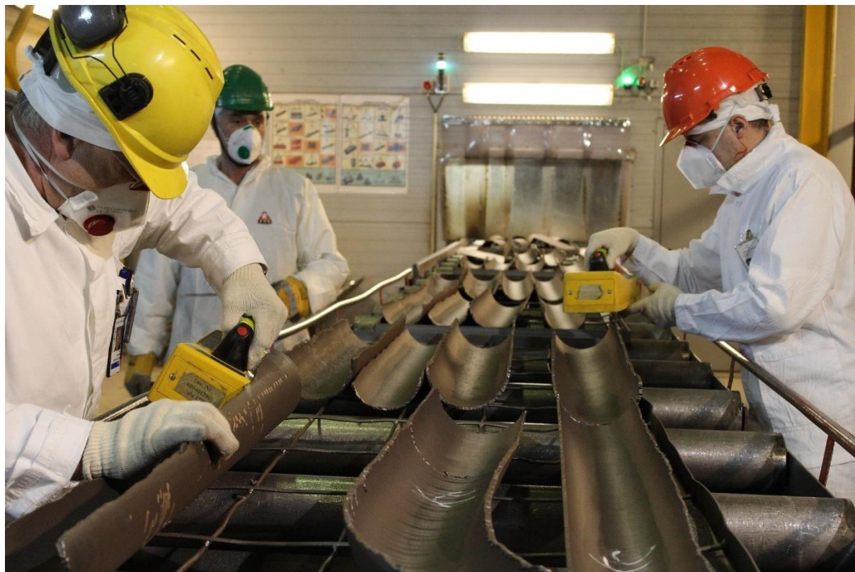
Рабочие демонтируют турбинный зал Игналинской АЭС и измеряют металлолом на предмет наличия следов излучения. (Фото: Дж. Донован/МАГАТЭ)
