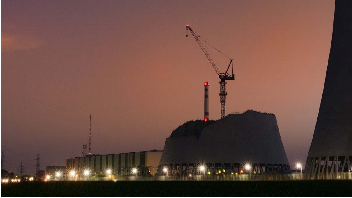
الشكل- باء-٢- تدمير أبراج تبريد محطة ٧١ للقوى النووية في سلوفاكيا (الصورة من: شركة القوى النووية والإخراج من الخدمة، العامة المحدودة)
