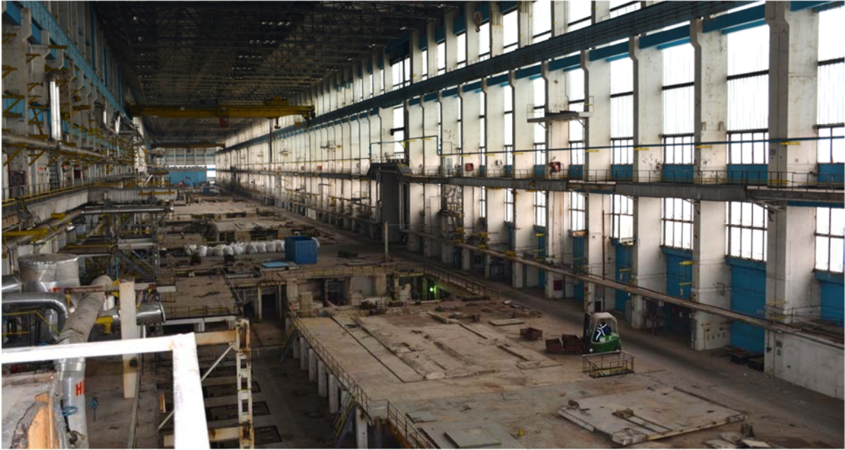
科兹洛杜伊核电厂 1 号至 4 号机组涡轮机大厅的拆除活动接近完成，保加利亚科兹洛杜伊，2019 年 11 月。（照片来源：保加利亚国家放射性废物公司）
