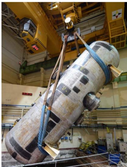
Fig. A-12. Retirada de los últimos 12 generadores de vapor, de 145 toneladas, de la central nuclear Bohunice V-1 clausurada en Eslovaquia. (Fotografía: Empresa de Actividades Nucleares y de Clausura JAVYS)
