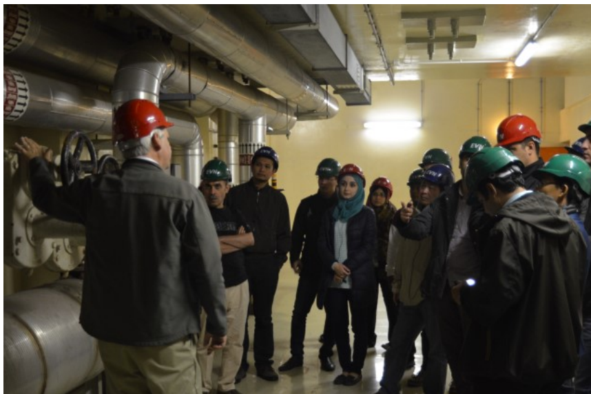
РИС. 1. Участники ознакомительного посещения АЭС "Цвентендорф", Австрия, которая так и не была введена в эксплуатацию, во время одного из двух таких учебных мероприятий, проведенных Агентством в 2015 году.
