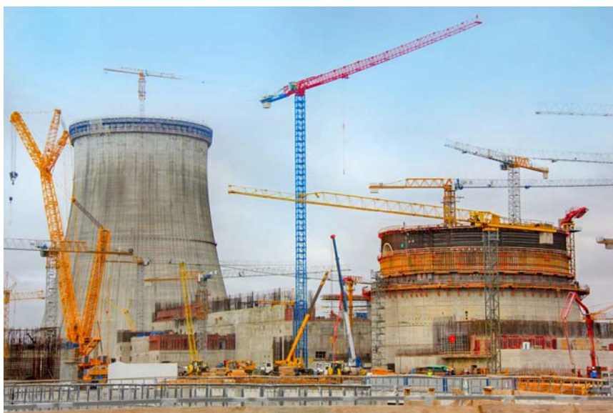
Рис. 1. Строительство энергоблоков 1 и 2 Островецкой АЭС в Беларуси (фото: Дирекция строительства атомной электростанции, Беларусь).
