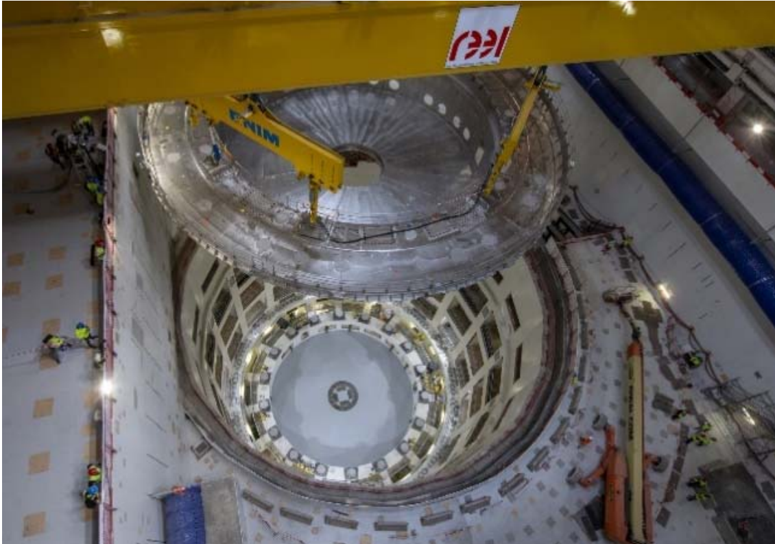
Fig. A-5. La base del criostato, de 1250 toneladas, fue el primer componente a gran escala instalado en el fondo del pozo de ensamblaje del Tokamak de 30 m de profundidad. (Fotografía: Organización ITER)
