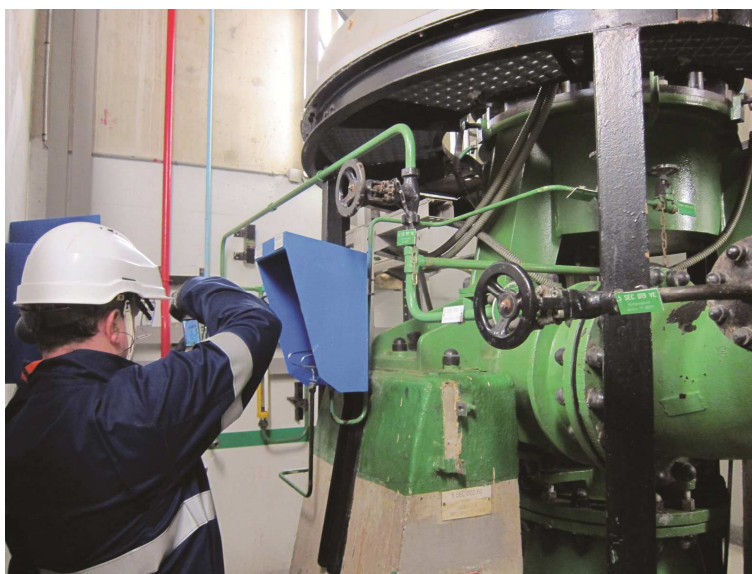
Fig. 1. Un examinador del Organismo en una misión de seguimiento OSART evalúa la funcionalidad de una bomba de agua de servicio esencial en la central nuclear de Gravelines (Francia).
