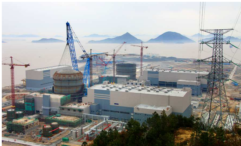
Fig. 3. Instalación del casquete de contención de una unidad de la central nuclear de Sanmen, una de las muchas centrales nucleares que se construyen en China, país que tiene un programa nucleoelectrico en expansión. (Fotografía por cortesía de CNNC).
