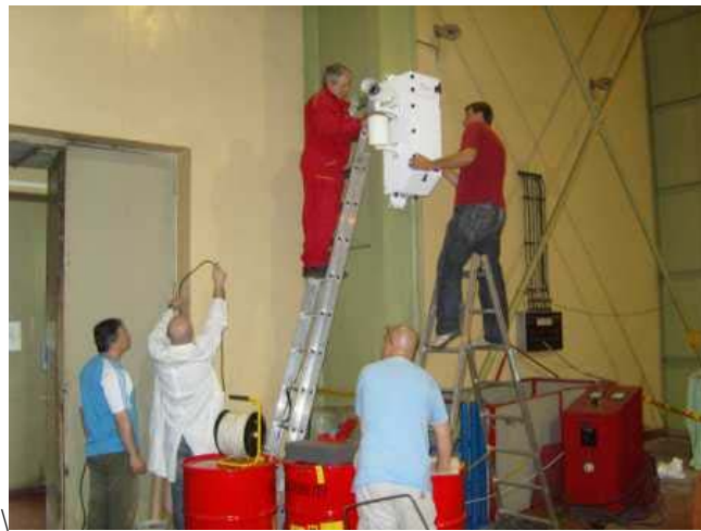
FIG. 2. Mise en place d'équipement de télésurveillance pour améliorer la protection physique d'une installation nucléaire.
