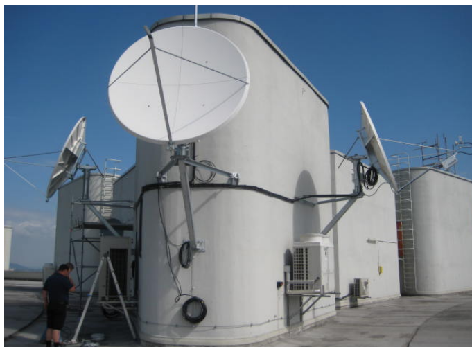
FIG. 7. Station de réception des données de télésurveillance au Siège de l'Agence.
