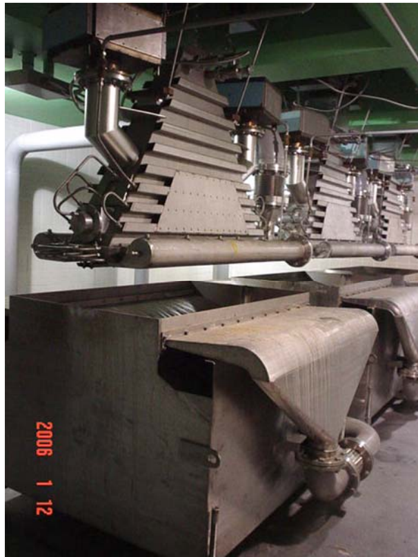
Fig.1. La première usine industrielle de traitement des eaux usées par faisceaux d'électrons en service en République de Corée.
