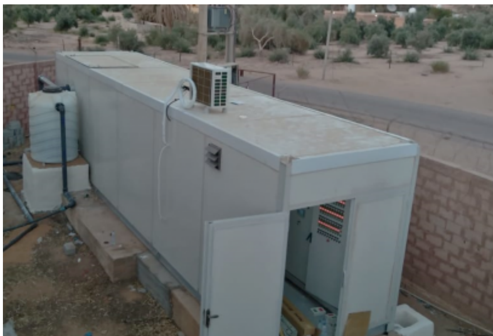
水处理装置于2020年12月完工，有助于利用较老的砂岩地下水含水层。 (图/约旦水务局A. Al-Sayaheen)
