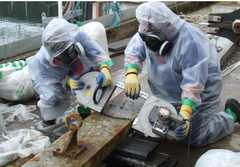
Personnel de déclassement découpant une pièce de gros équipement métallique dans une installation nucléaire.
