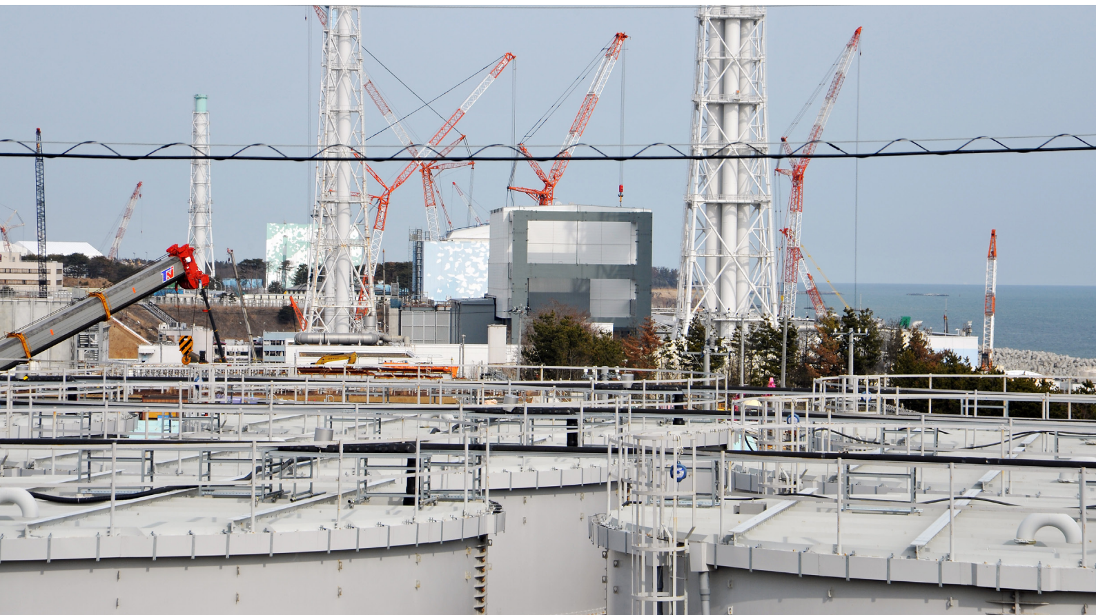
Réservoirs d'eau contaminée, avec en arrière-plan les bâtiments des réacteurs de la centrale de Fukushima Daiichi.
