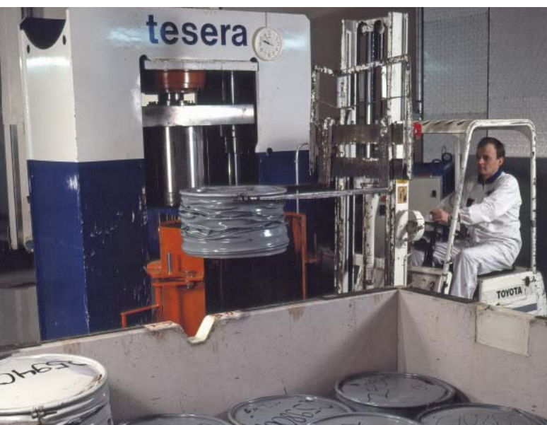
Установка "Суперкомпактор" для контейнеров с твердыми отходами. (Фото: "Теоллисууден воймай ой" (ТВО), Финляндия)
