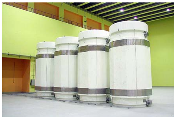
FIG. 2. Châteaux d'entreposage provisoire et de transport à ZWILAG (Suisse).
