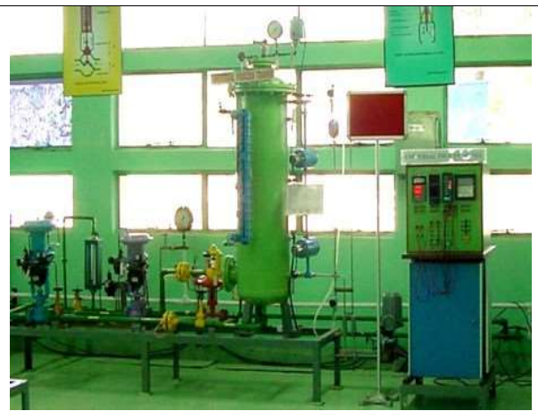
Mini Power Station
