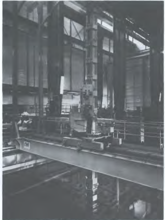
Бассейны-хранилища отработавшего топлива на перерабатывающем заводе на мысе Ла-Аг.
