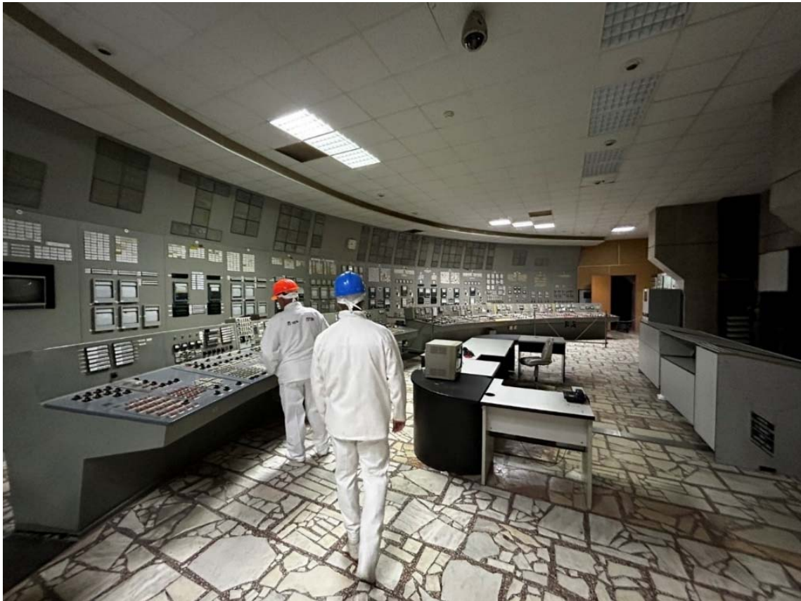
Visita del primer grupo de la ISAMICH a la sala de control principal de la unidad 3 de la ChNPP el 5 de octubre (Fotografía: OIEA)
