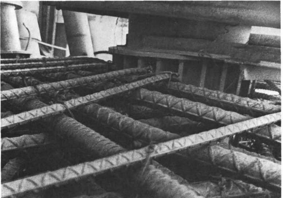
Foto N o 10. Redes de barras de acero laminado entrecruzadas dispuestas para el vertido del hormigón.
