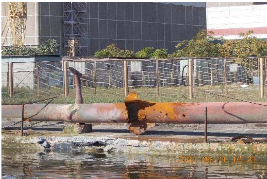
Daños en una tubería observados por la ISAMZ en el emplazamiento de la ZNPP debidos al bombardeo del 21 de septiembre. (Fotografía: OIEA)
