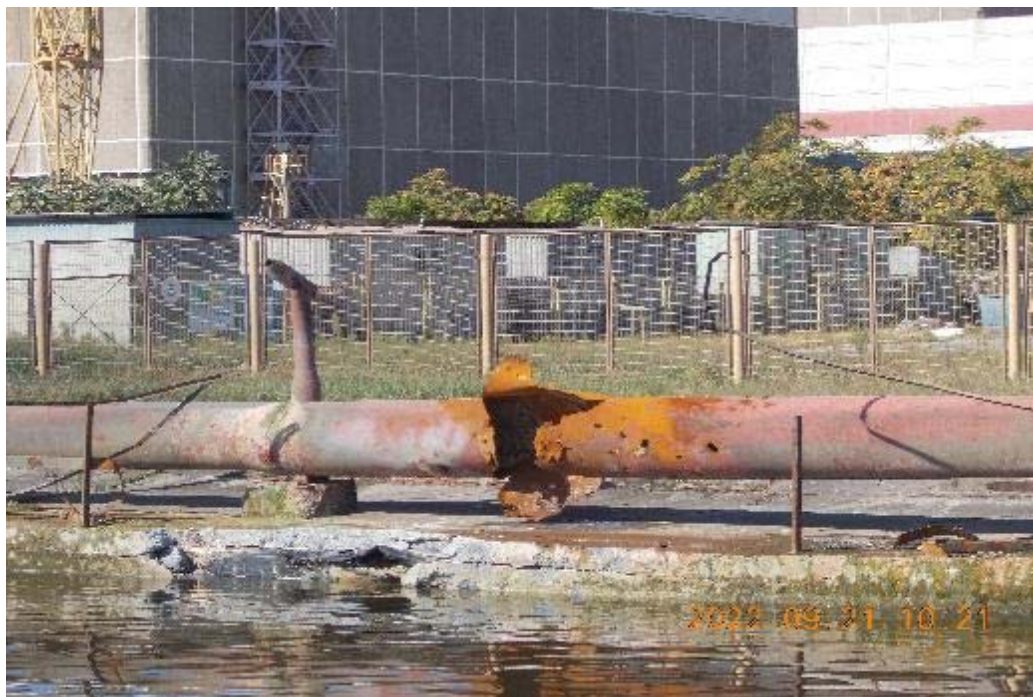
Повреждение трубы, визуально зафиксированное ИСАМЗ на площадке ЗАЭС в результате обстрела 21 сентября (Фото: МАГАТЭ)
