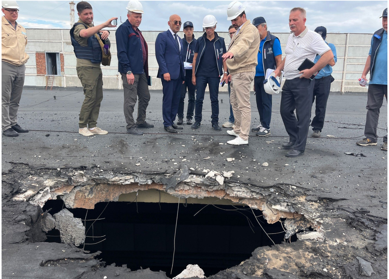
El grupo del OIEA observa los daños causados por bombardeos al techo del edificio especial de la ZNPP que alberga, entre otras cosas, el combustible nuclear no irradiado y la instalación de almacenamiento de desechos radiactivos sólidos. (Fotografía: OIEA)
