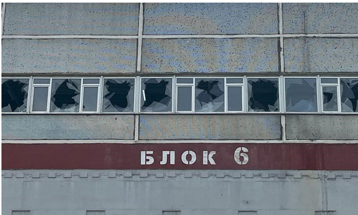
Daños causados por el bombardeo al pasaje elevado de la unidad 6 (Fotografía: OIEA)
