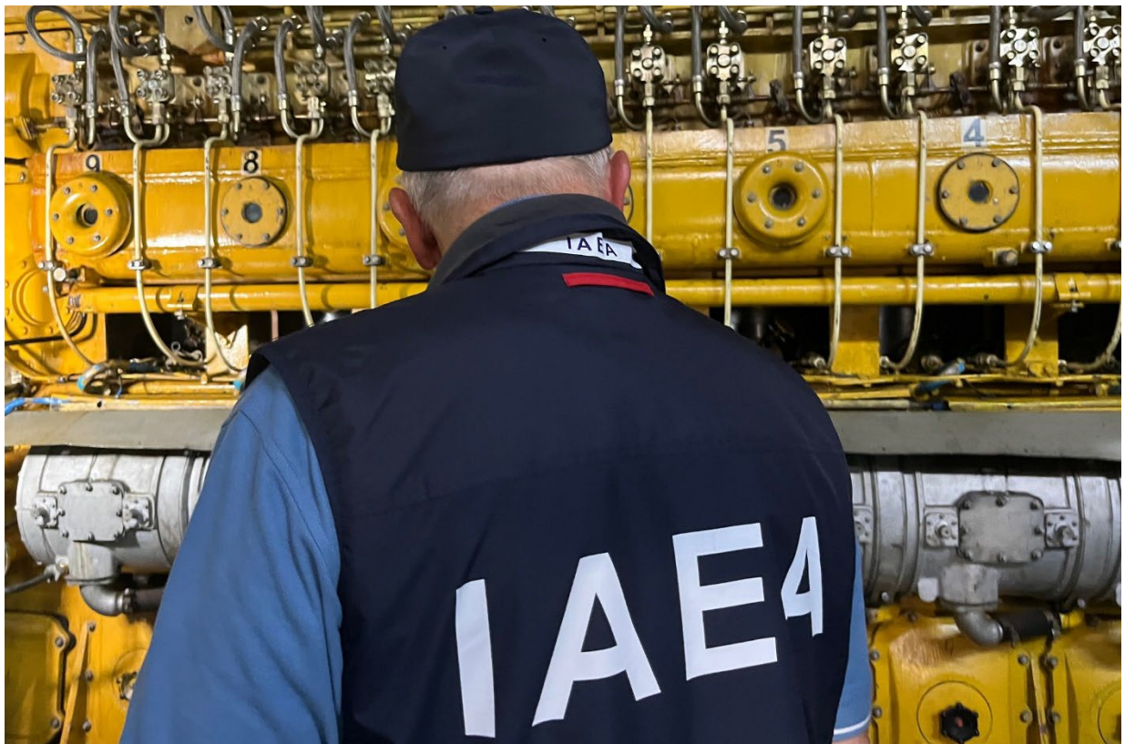
Expertos del OIEA visitan la sala de generadores diésel de emergencia de la unidad 5 de la ZNPP. (Fotografía: OIEA)
