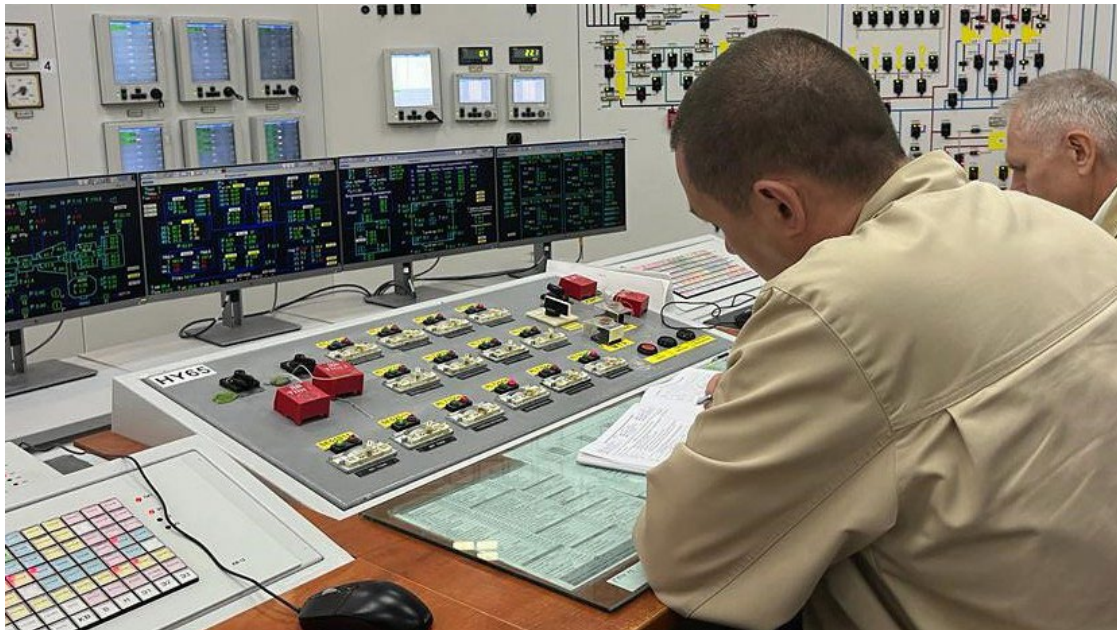
Operadores trabajan en la sala de control principal de la unidad 5 de la ZNPP. (Fotografía: OIEA)
