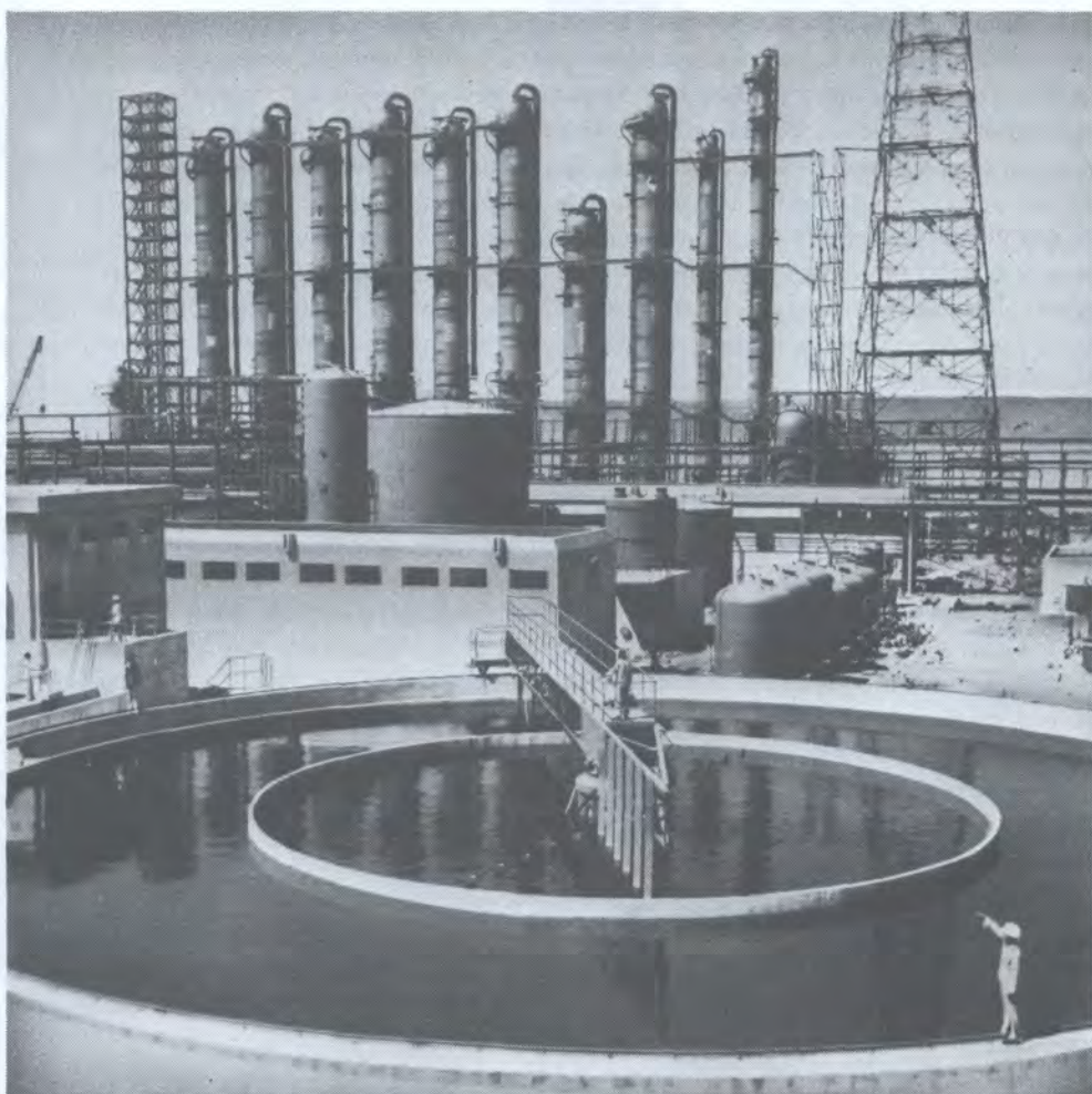
Рис. 4. Строящийся завод по производству тяжелой воды в Кота, на котором будет использоваться разработанная в Индии технология.
